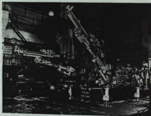
Рисунок 7 – Первые серийные образцы бурового агрегата УБШ-214 (справа) и УБШ-215 (слева) на рельсовом ходу
