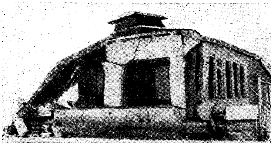
Фиг. 8-3. Школа Каммингс-Велли. Низкокачественный «армированный» бетон; разрушено землетрясением 21 июля 1952 г. (Фото Эдвина А. Вернера, инженера-строителя, Сан-Франциско.)
