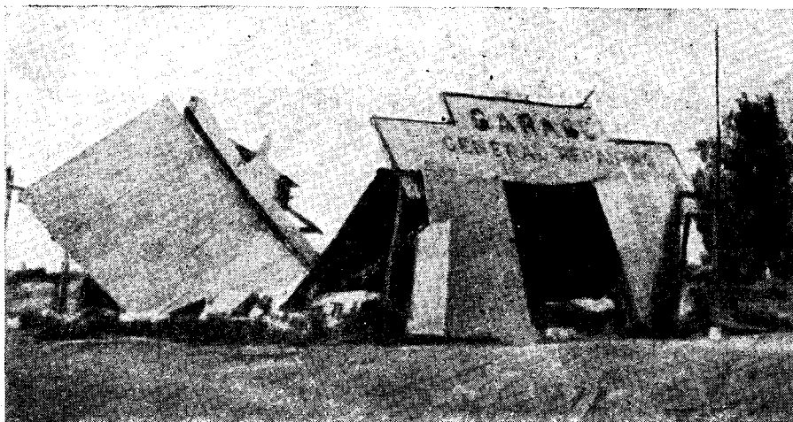
Фиг. 28-12. Землетрясение долины Импириал, 1940 г. Разрушение гаража в Милоленде. (Фото Бувалды.)
