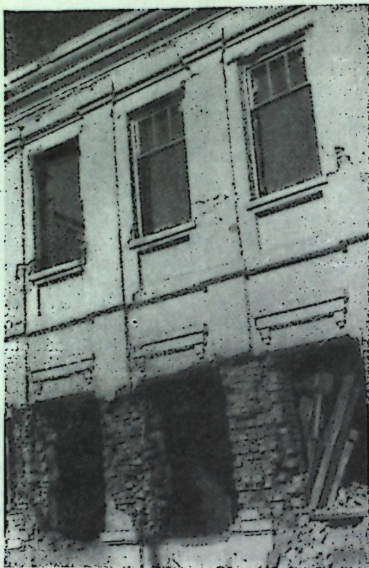
Фиг. 9. Отслоение наружных рядов кладки в простенках
