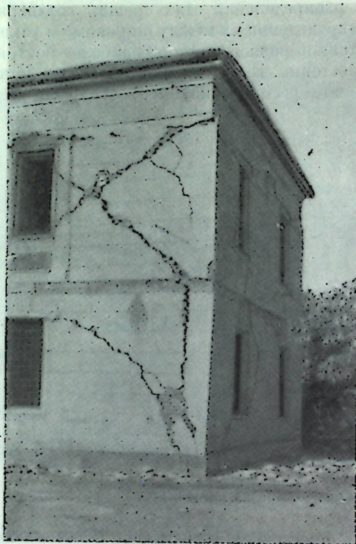
Фиг. 6. Разрушение стен по оси А в домах первой группы
