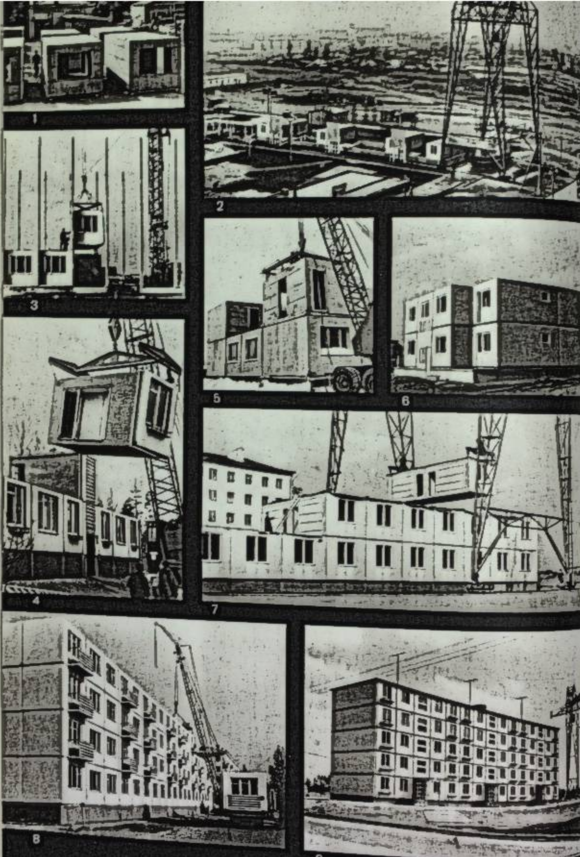
1. Ст. блок объемный. 2. Готовые объемные блоки на полигоне. 3. Установка объемного блока-комнаты. 4. 5. Монтаж жилых домов из объемных блоков. 6. 2-этажный 4-квартирный жилой дом. 7. Строительство жилого дома из прокатных ребристых объемных скорлуп. 8. Монтаж 4-го этажа жилого дома. 9. Жилой дом из объемных блоков.
