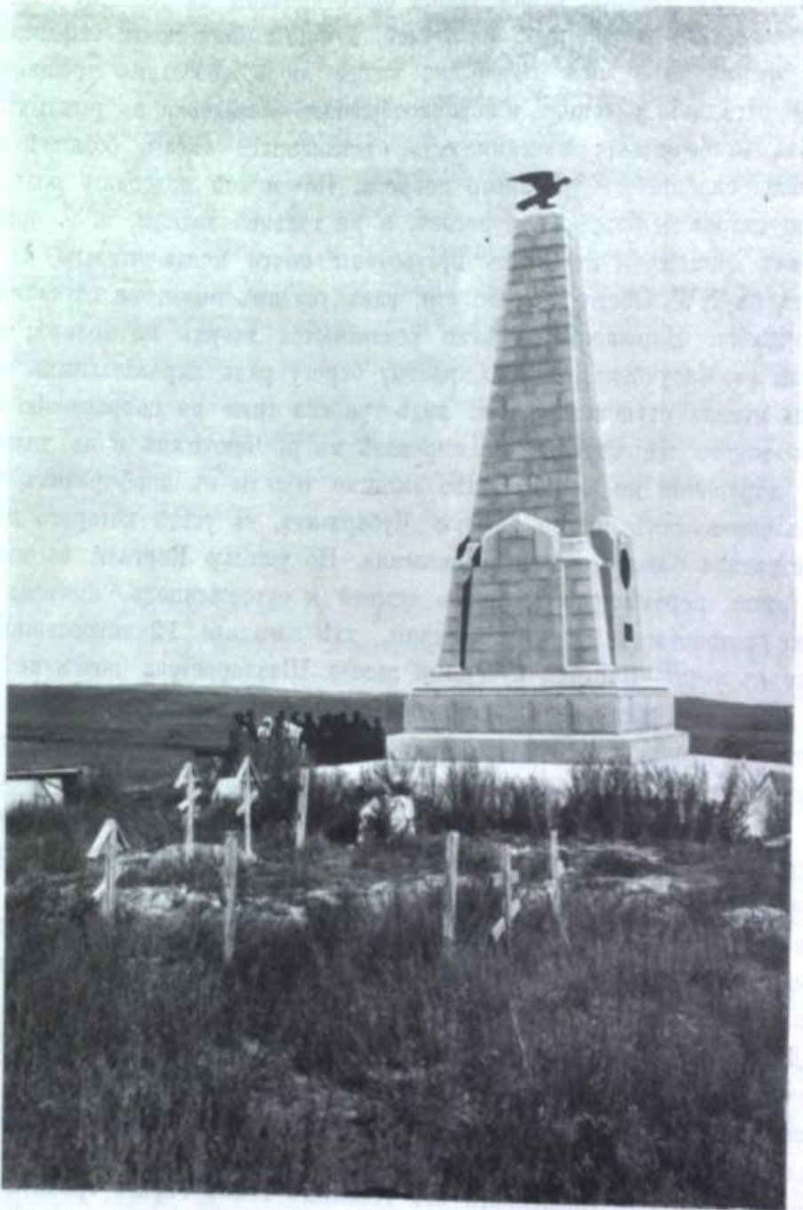
Фиг. 18. Памятникъ въ стан. Казанско-Богородской, давшій сквозную трещину по швамъ кладки, въ направленіи NW—SO, и незначительный сколъ камня на NW сторонѣ трещины. Если трещины, то онѣ круто падаютъ на NW и N; самая обмозка (туземная штукатура) падала туда же; высокіе дувалы (напр., въ караванъ-сараѣ Султанъ-куль—
