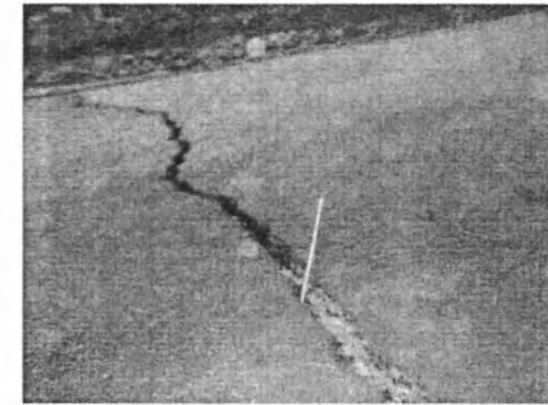
Рис. 10. Трещина в асфальтовой дороге села Нура. Трещина глубиной 15 см заметно расширяется в сторону ЮВ.
