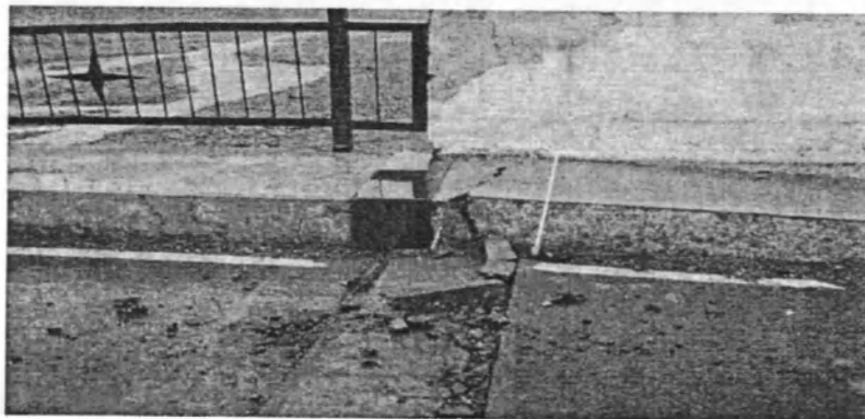
Рис. 9. Железобетонный мост имеет легкое повреждение.
