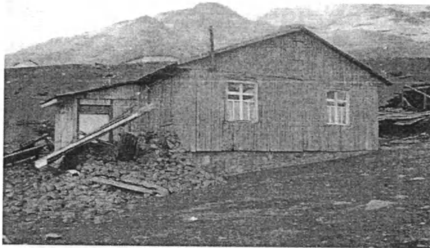
Рис. 8. Щитовой дом, разрушена только пристройка, построенная из кирпича-сырца.
