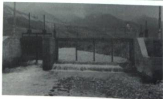
Фото 2(а, б). Водозаборные сооружения донно-решетчатого типа на реках Каракол и Сокулук
