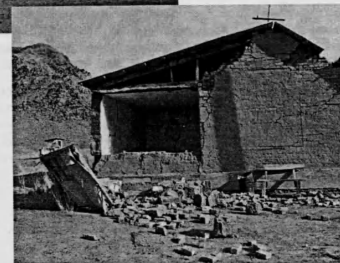
Разрушения, вызванные Кочкорским землетрясением, произошедшим 25 декабря 2006 г.
