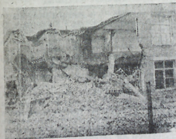
Рис. 7. Обрушение части двухэтажного кирпичного здания с железобетонным перекрытием в северной части пгт Газли ( d_B = 4,0 и J_B = 9,2 ).
